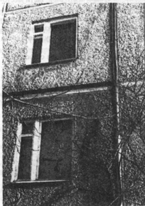
Рис. 2. Трещины в стенах дома № 19 по ул. Театральная
