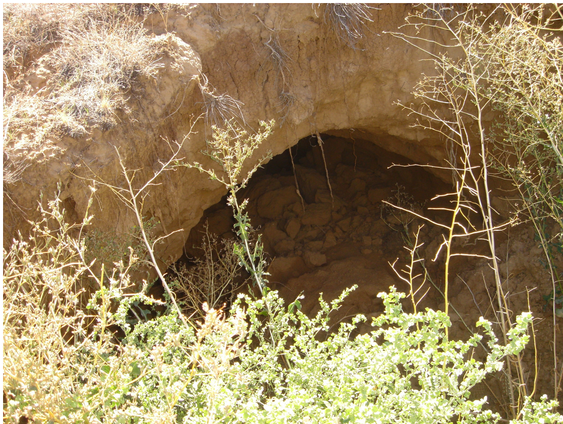
Фотоснимок 4. Суффозионная воронка в стенке водоотводного канала
