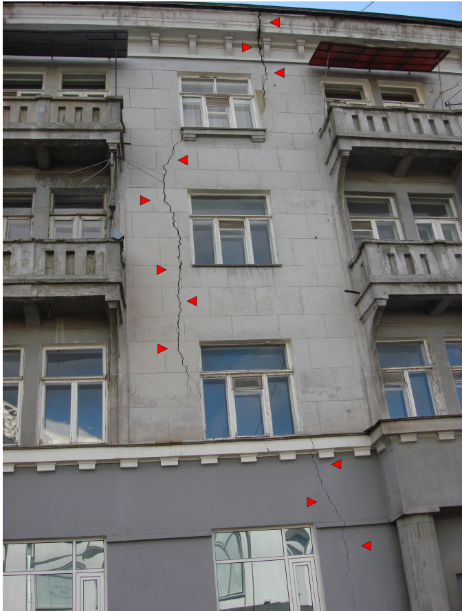
Фотоснимок 1. Деформации жилого дома, вызванные суффозией, отмечены стрелками (Саратов, ул. Чапаева / Сакко и Ванцетти, 2008 г.)
