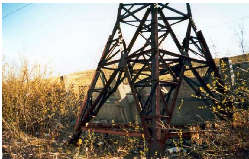
Рис.4. Оползень вблизи территории областной психиатрической больницы. Вид на аварийную подпорную стенку у опоры высоковольтной ЛЭП-110 кВт (фото 27.04.2006 г.)
