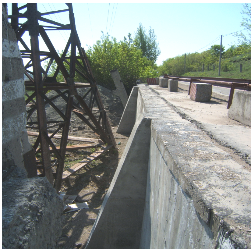
Рис.5. Вид на новую подпорную стенку у опоры высоковольтной ЛЭП-110 кВт по дороге к областной психиатрической больницы (фото 17.05. 2007 г.)
