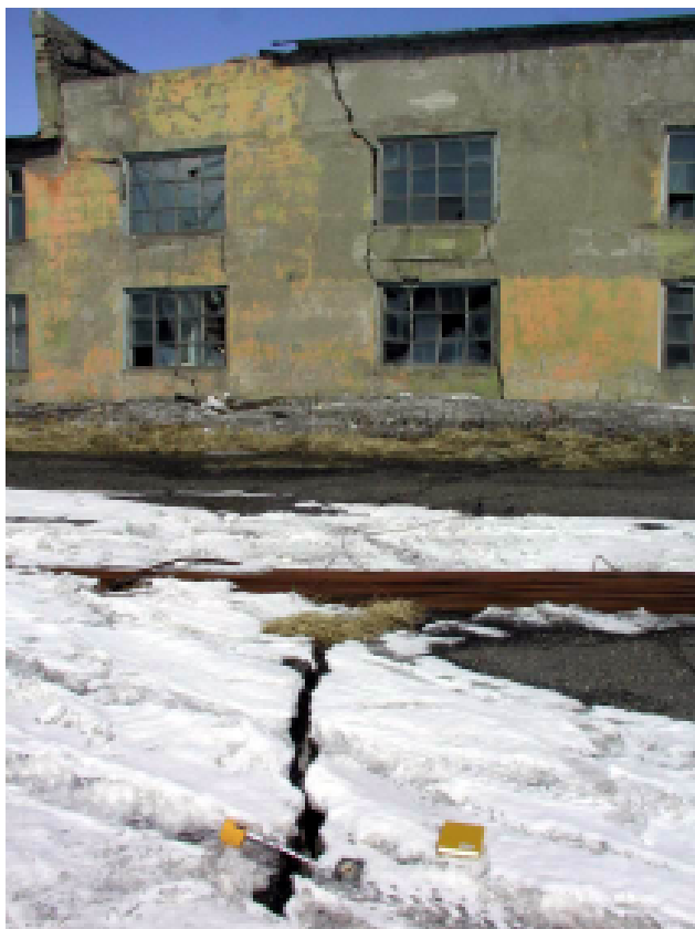
Рис. 7. Трещина в грунте, проходящая через бетонное здание, пос. Корф.
