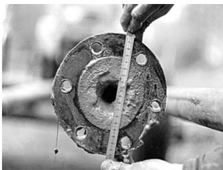
Рис. 2. Осадки на внутренней поверхности насосного фланца. Водозабор Академгородка
