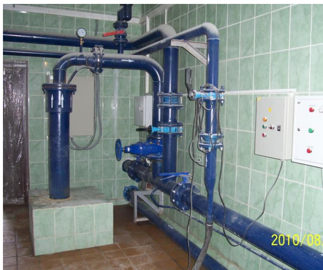
Рисунок 1 – Устье скважины Вычулковская 201 для получения теплой воды.
