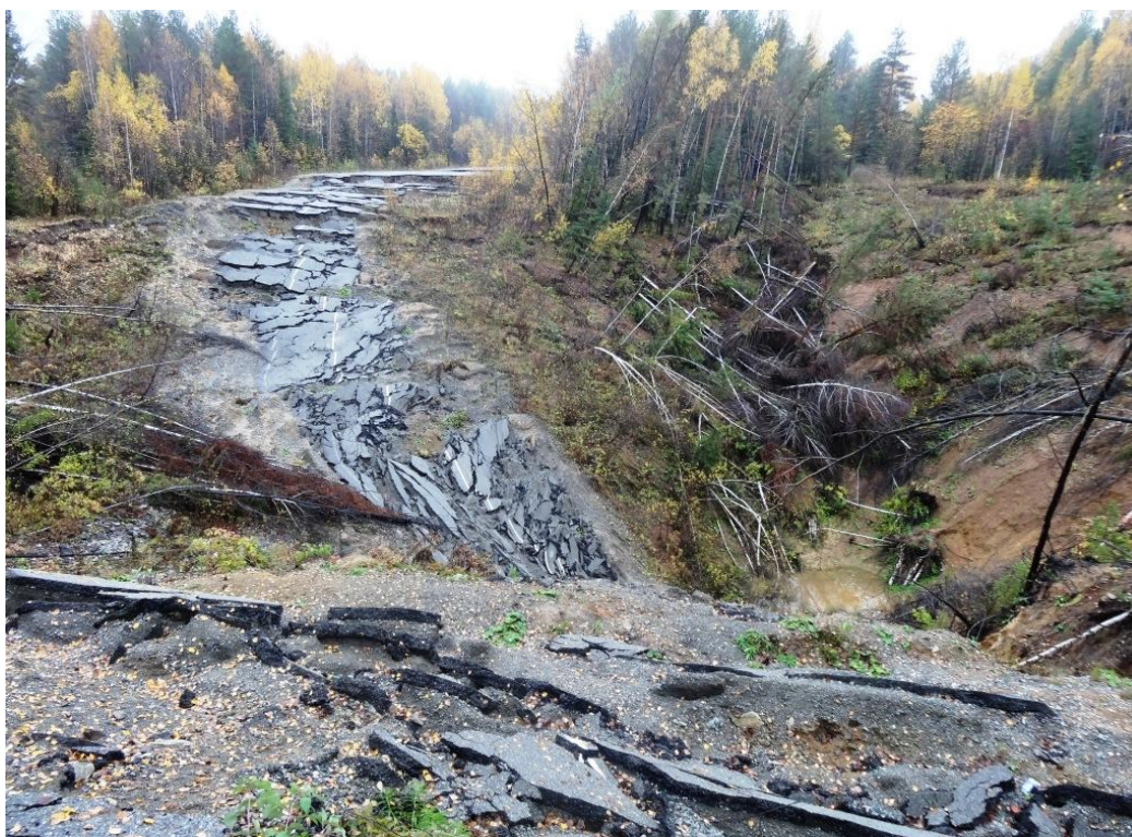
Рис. 1 – Юго-западное направление зоны обрушения и зоны трещин по состоянию на ноябрь 2013 г.
