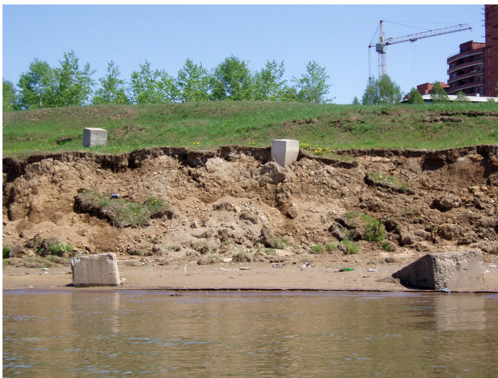
Рис. 17. Проявление абразионного процесса на берегах Иркутского водохранилища (микрорайон Солнечный, фото 2011 г.).
