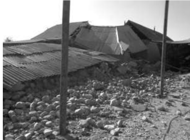
Рис. 4. Майртуп. Обрушение дома, сложенного из камня на цементном растворе
