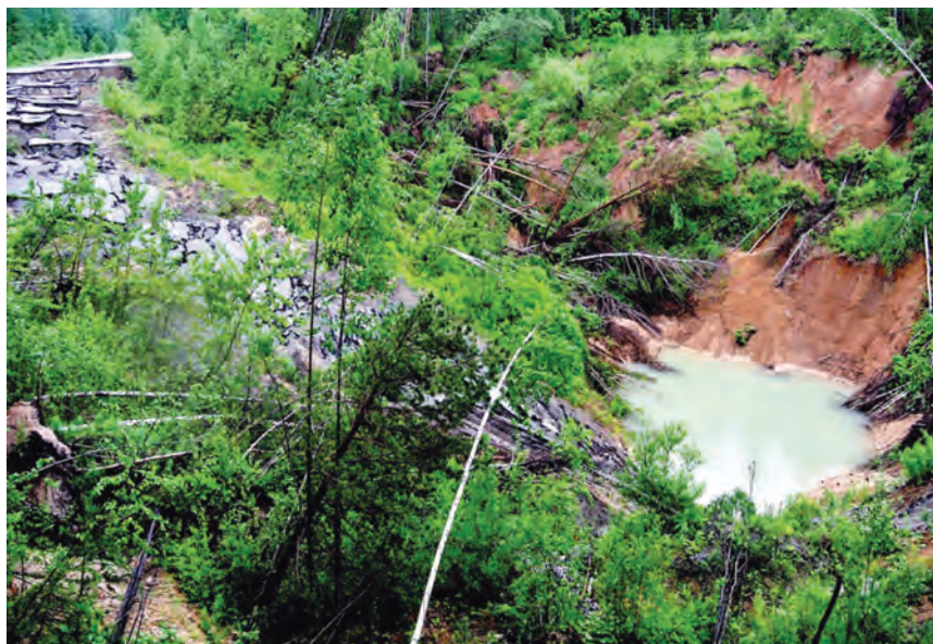
Рис. 2. Фактическое состояние зоны обрушения и бывшей автодороги
