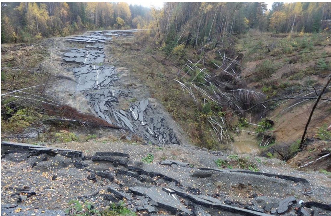
Рис. 5 – Образование зоны обрушения над Южной залежью в депрессионной зоне (октябрь 2013 г.)
