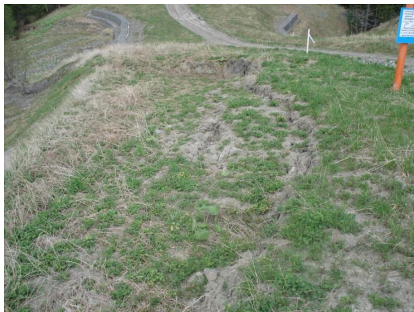
Рис. 3. Трещина отрыва, появившаяся весной 2017 г. в насыпных грунтах на оползневом участке
