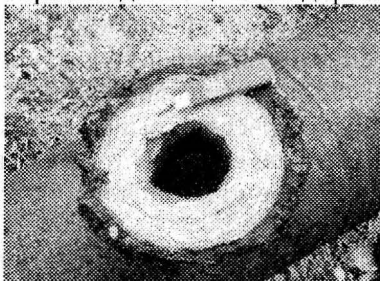
Тульское месторождение, Республика Адыгея. Отложения в соединительной трубе после 2 лет эксплуатации
