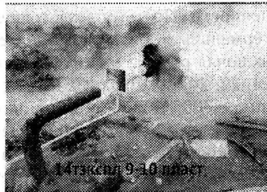
Скважина 14 Ханкальское месторождение, Чеченская Республика. Состояние устьевого оборудования
